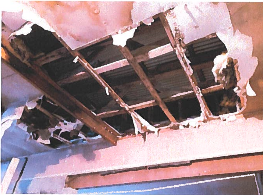
Lager Kjosen: taktekke bør skiftes og forsterkes snarest
