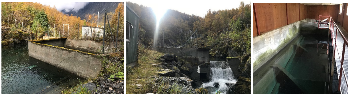
Figur 5. Vanninntak med demning (venstre), overløp (midten) og rentvannsbasseng (høyre) (Foto: H. Kvitsand).
