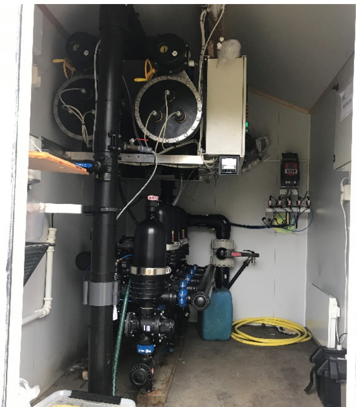
Figur 6. Vannbehandlingsanlegget ved Gjerdelva (Foto: H. Kvitsand).
