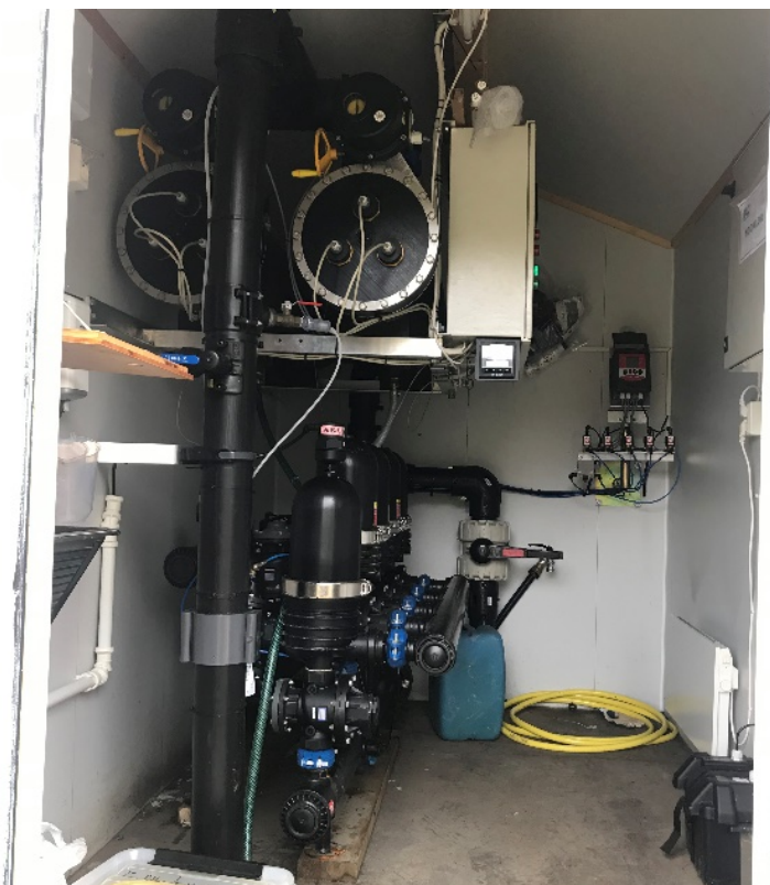
Figur 6. Vannbehandlingsanlegget ved Gjerdelva (Foto: H. Kvitsand).
